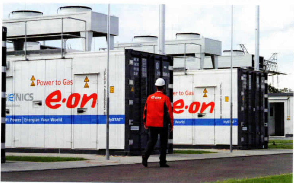
Neben der kürzlich in Hamburg eingeweihten Power-to-Gas-Anlage betreibt E.ON bereits seit 2013 im brandenburgischen Falkenhagen eine Pilotanlage – mit positiver Bilanz.
